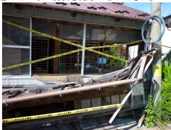
【倒壊したままの民家】
